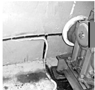
Лифтовое оборудование на ул. Воронова (было).
