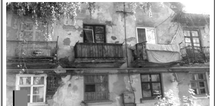
ДО КАПРЕМОНТА: Каменка, ул. Рокоссовского, 43.
